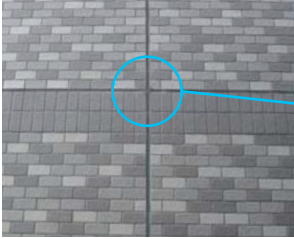
打継目地 (タイル面・塗装面)
